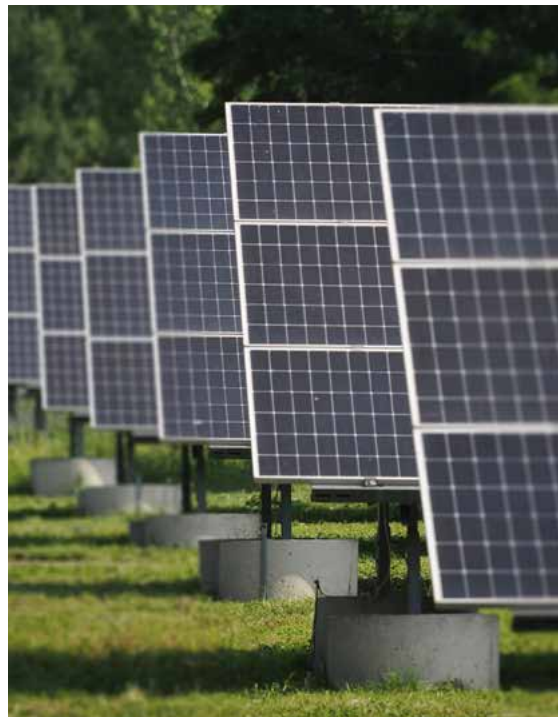
Fot. Błażej Boryń, Farma fotowoltaiczna
